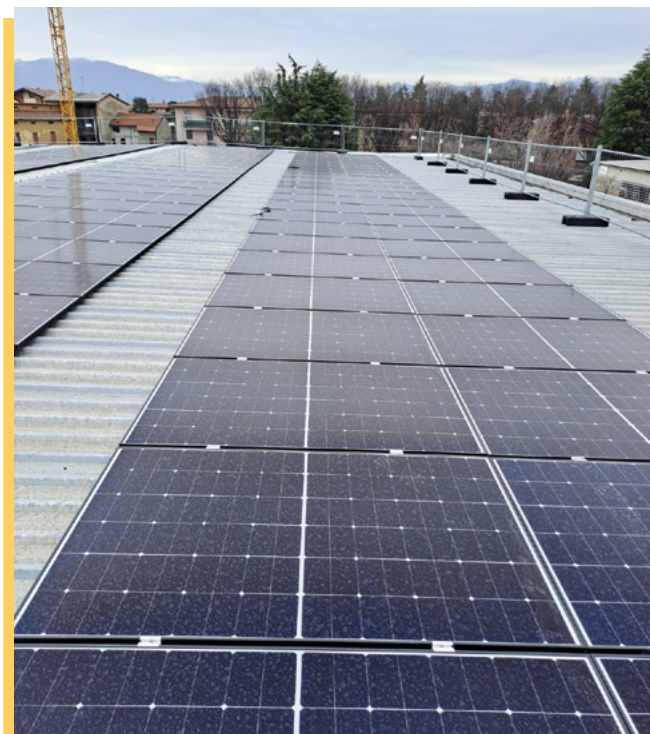
Nuovo impianto fotovoltaico Campus
